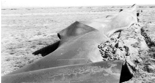
Рис. 2. Разрушение магистрального газопровода по причине КРН (спиралешовная труба, сталь 17Г1С, плато Устюрт)
