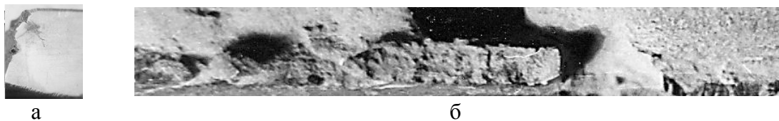
Рис. 6. Раскрывшиеся трещины: а – вид сбоку (поперечное сечение); вид сверху (перпендикулярно поверхности трубы)
