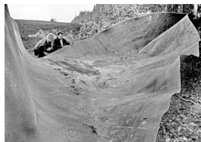
Рис. 3. Разрушение магистрального газопровода по причине КРН (прямошовная труба, сталь Х70, Уфимское плато)
